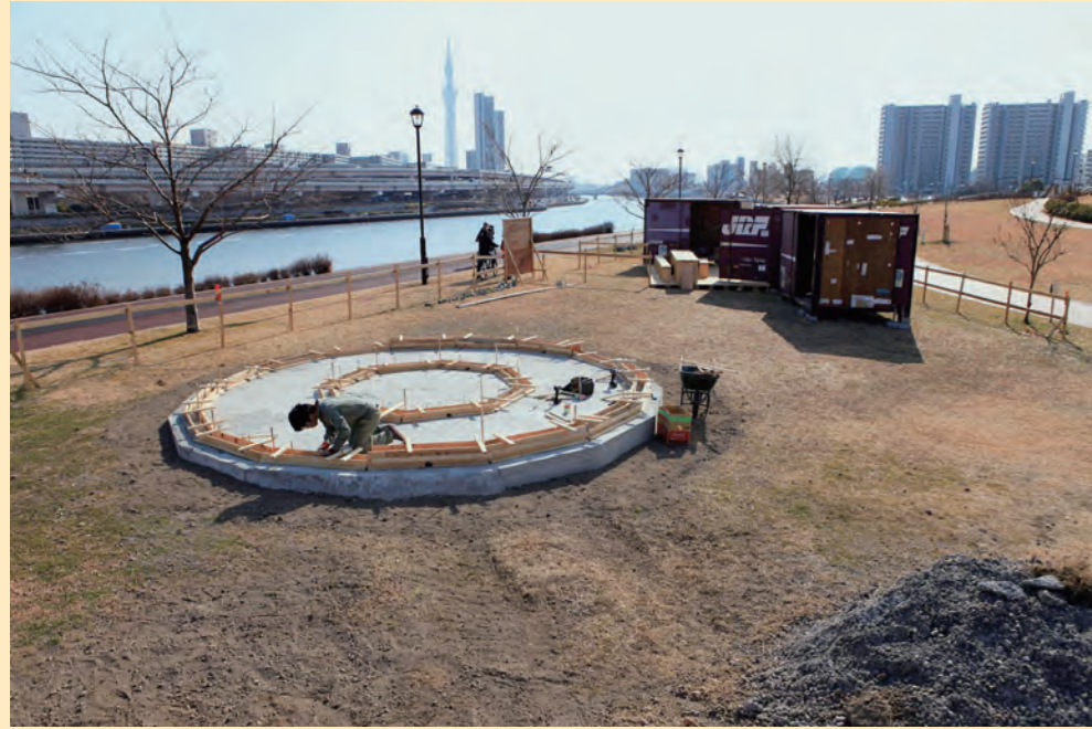
基礎の立ち上がり部分に生コンクリートを流し込む,立ち上がり生コン打ち
