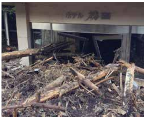
土砂災害でたくさんの倒木が積み上がったホテル椿園玄関前
